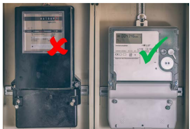
Abbildung 4: Ferraris-Zähler (links), Zweirichtungszähler (rechts),
